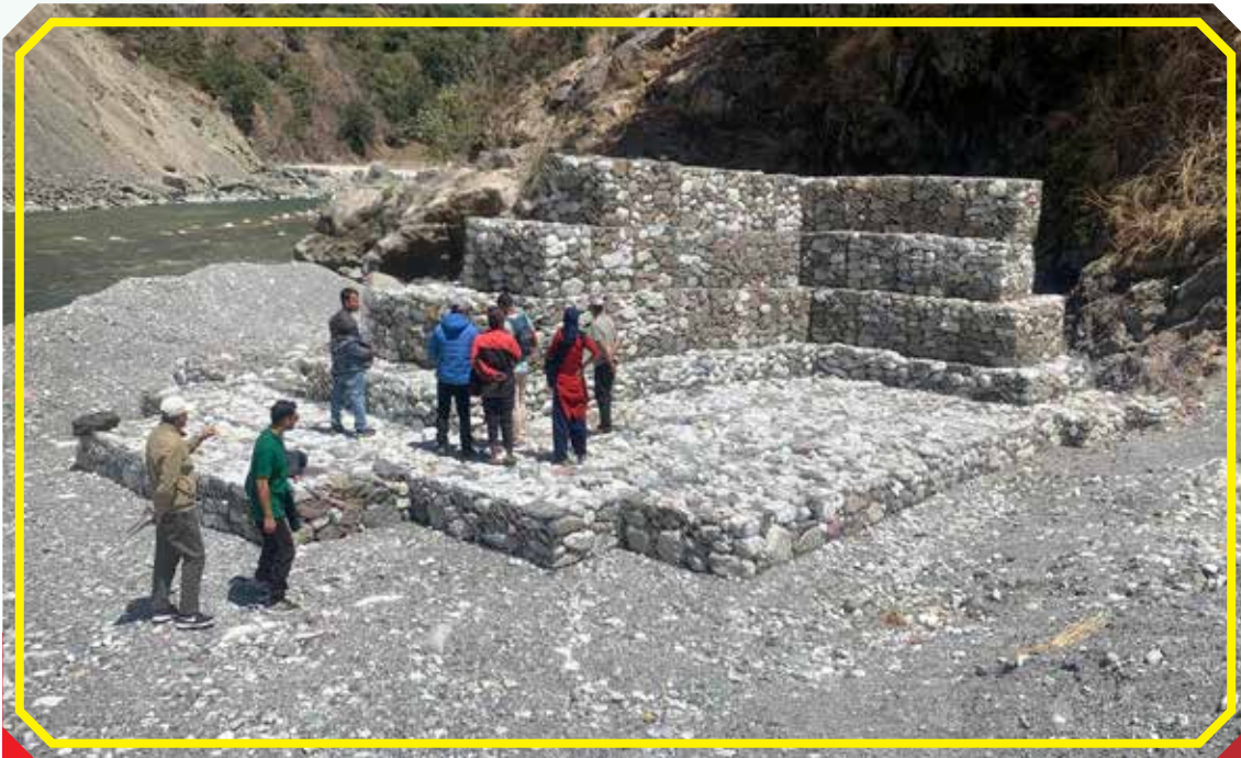
भूमे ५, बालुवा (सानी भेरी)मा सम्पन्न भएको नदी किनारा संरक्षण अन्तर्गन निर्माण गरिएको स्पर:
